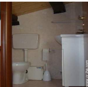
Confort interior e instalaciones
